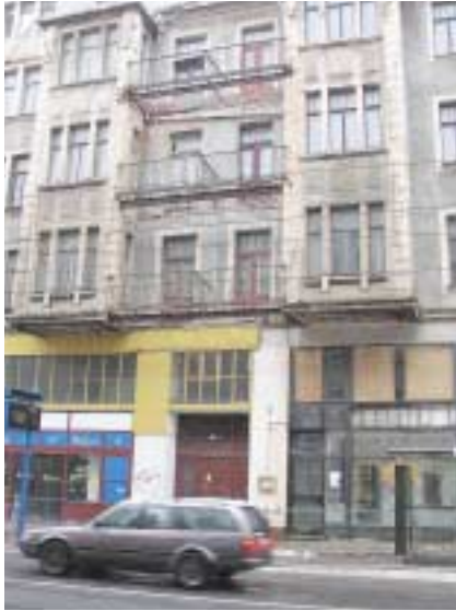
Fassaden wie in der Eisenbahnstr. 78 müssen dringend saniert werden, aber ohne Fördermittel sieht es schlecht aus.
